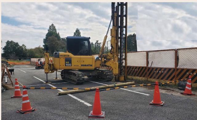
写真-2 重機の作業範囲内立入禁止措置
