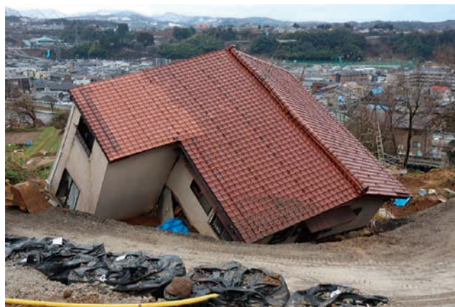
写真-8 地すべり災害事例 4)
