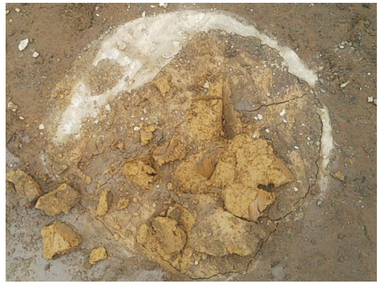
写真-1 柱状改良杭頭付近に土塊となって留まった凝灰質粘土
