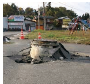
写真-17 浮上したマンホール
