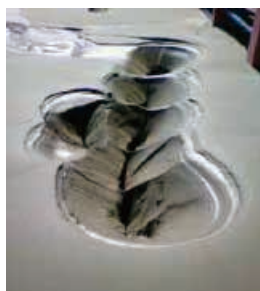
写真-16 液状化による噴砂
