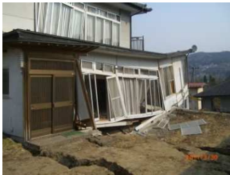
大規模盛土造成地の地震被害例
