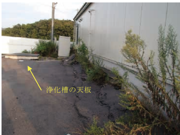
写真-1 構造物周辺の沈下状況（松江市）
