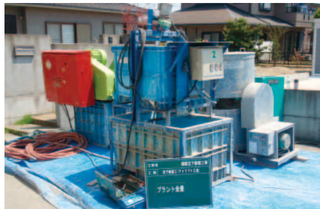
写真-1 定置プラント
