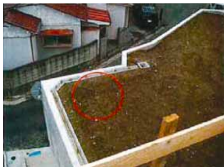
造成盛土の水浸沈下状況
