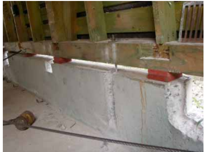
写真-4 天端の隙間の基礎との状況
