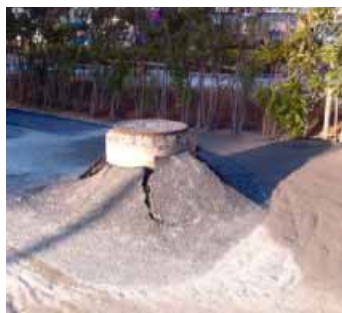
写真-1 液状化による浮上したマンホール（千葉県浦安市）
