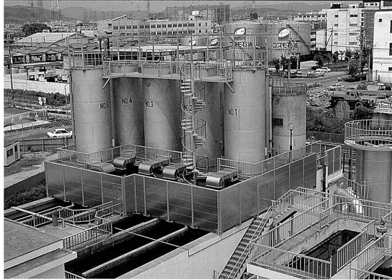
アーレーションタワー全景 (高槻市水道部大冠浄水場)
