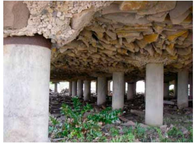
写真-1 地盤沈下による抜け上がり現象（白石地区）
